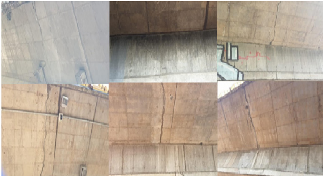
Fig. 1. Fisuras generadas por fatiga del material de las losas de concreto.
