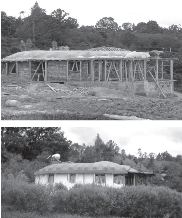
Figura 1. Proceso de la casa en bahareque y cubierta en domocaña Reserva Natural Cochahuaira, Gachantivá, Boyacá. Proyecto y construcción: arq. Clara Ángel. Fuente: propia
