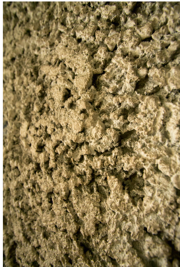
Figura 2. El revoco rústico en el edificio Las Carabelas. Fuente: elaboración propia.
